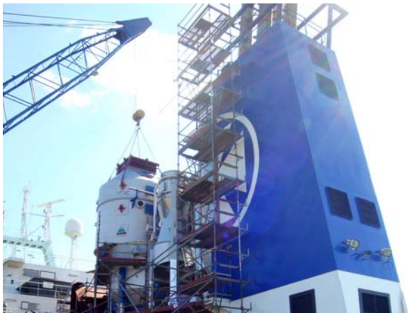
主機排ガス浄化装置 [DFDS M/V Tor Fiscaria搭載]
